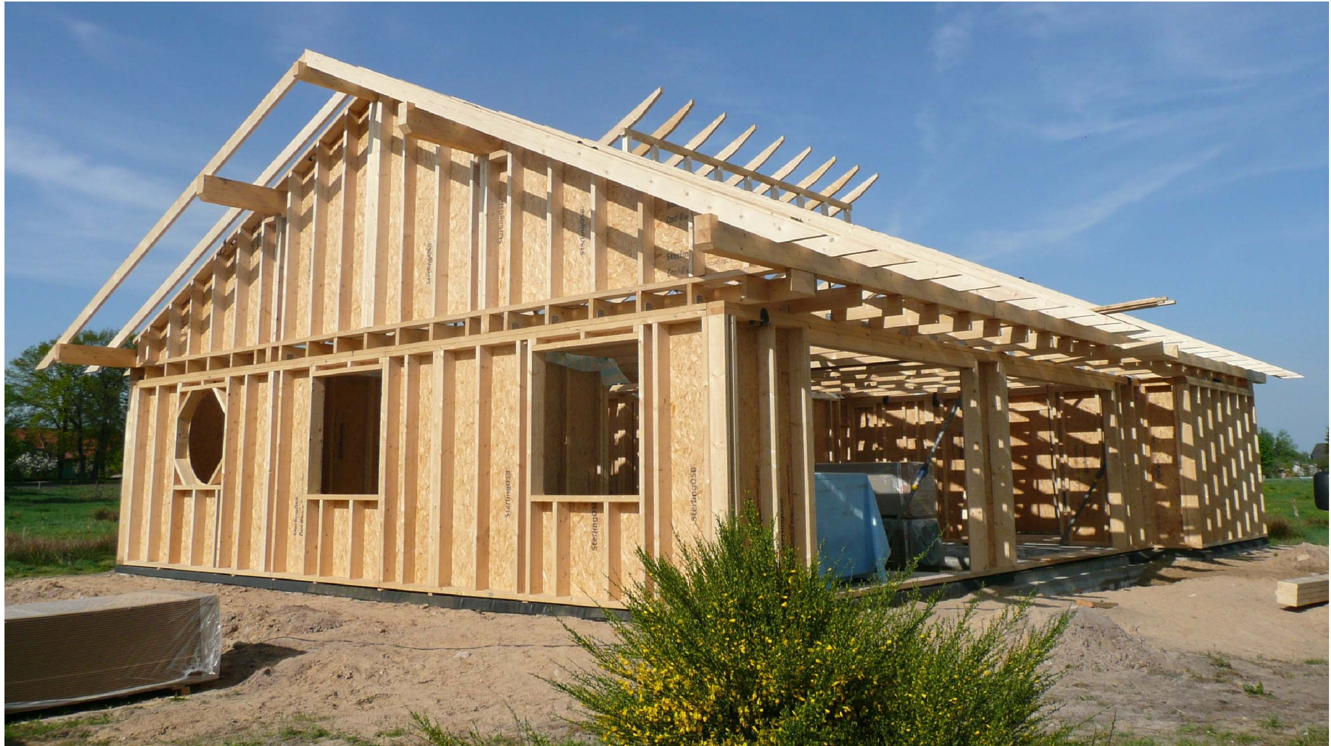
Das Architektenhaus 165 sehen Sie in diesem Beispiel als Ausbauhaus und befindet sich zur Zeit (Mai 2008) im Rohbauzustand.
